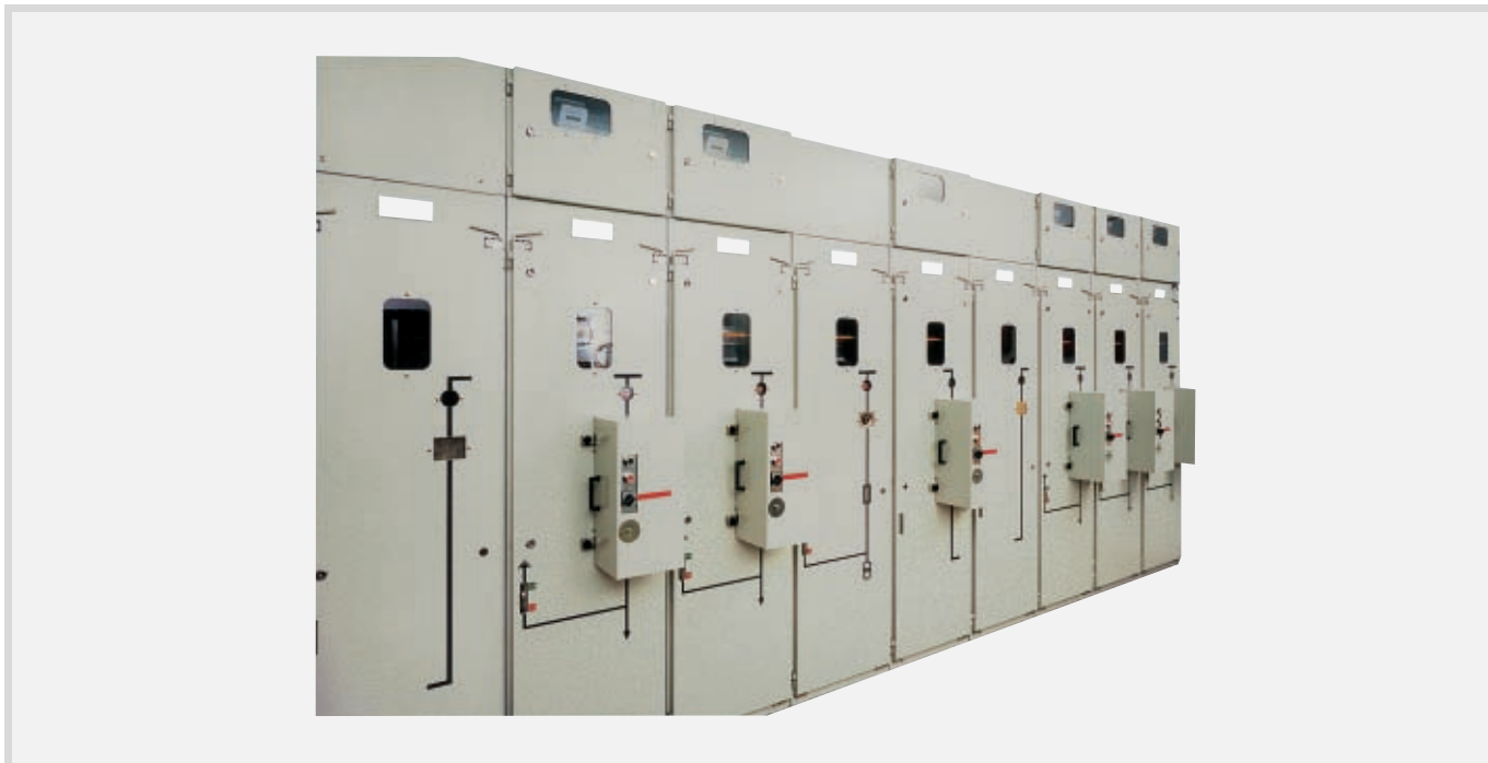
Lasttrennschalterfelder mit angebaurem Motorantrieb, Bautiefe insgesamt: 970 mm
