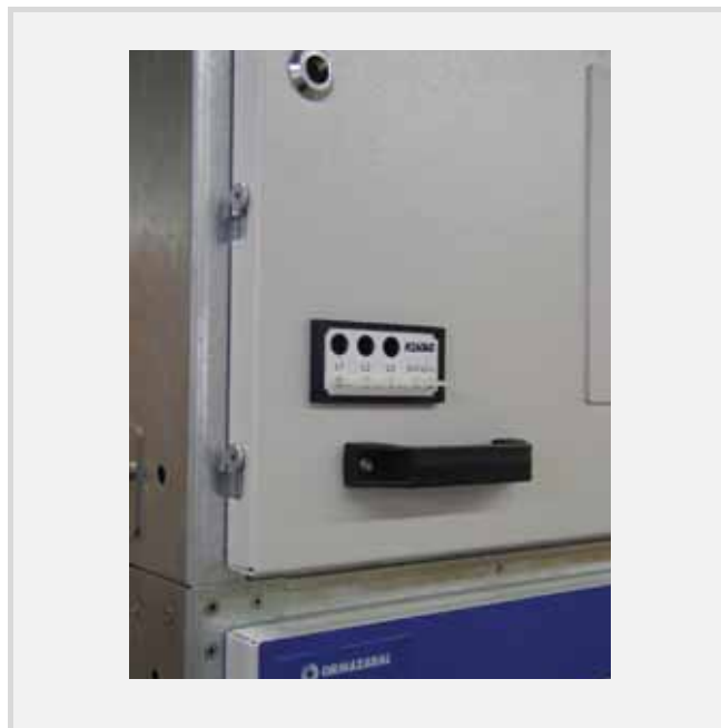
Емкостная система выявления напряжения расположена на дверце отсека низковольтной аппаратуры
