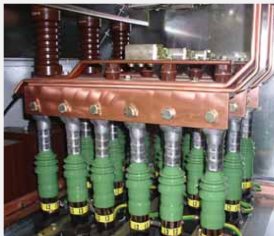
Тип щита АМС9-12/2500-2500/31-Л отсек кабельного присоединения с 6х1х500мм 2 на фазу, с емкостными изоляторами
