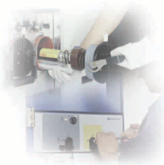
Sicherungsinstallation und Abläufe
